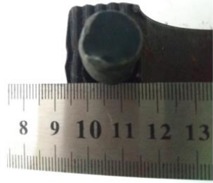
Gambar 3. Pernukaan ujung baut patah
