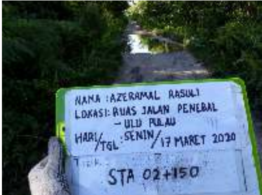
Gambar 1 Kerusakan pada ruas jalan Penebal -Ulu Pulau
