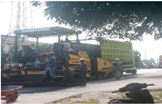
Gambar 9 Penggunaan Baju Safety dan Jaga Jarak Aman Yang Tidak Dilakukan
