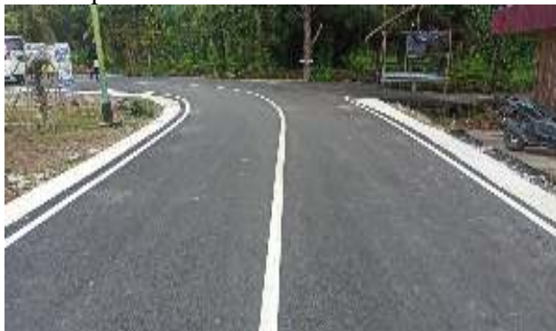
Gambar 3 Kondisi Jalan STA 00+000
